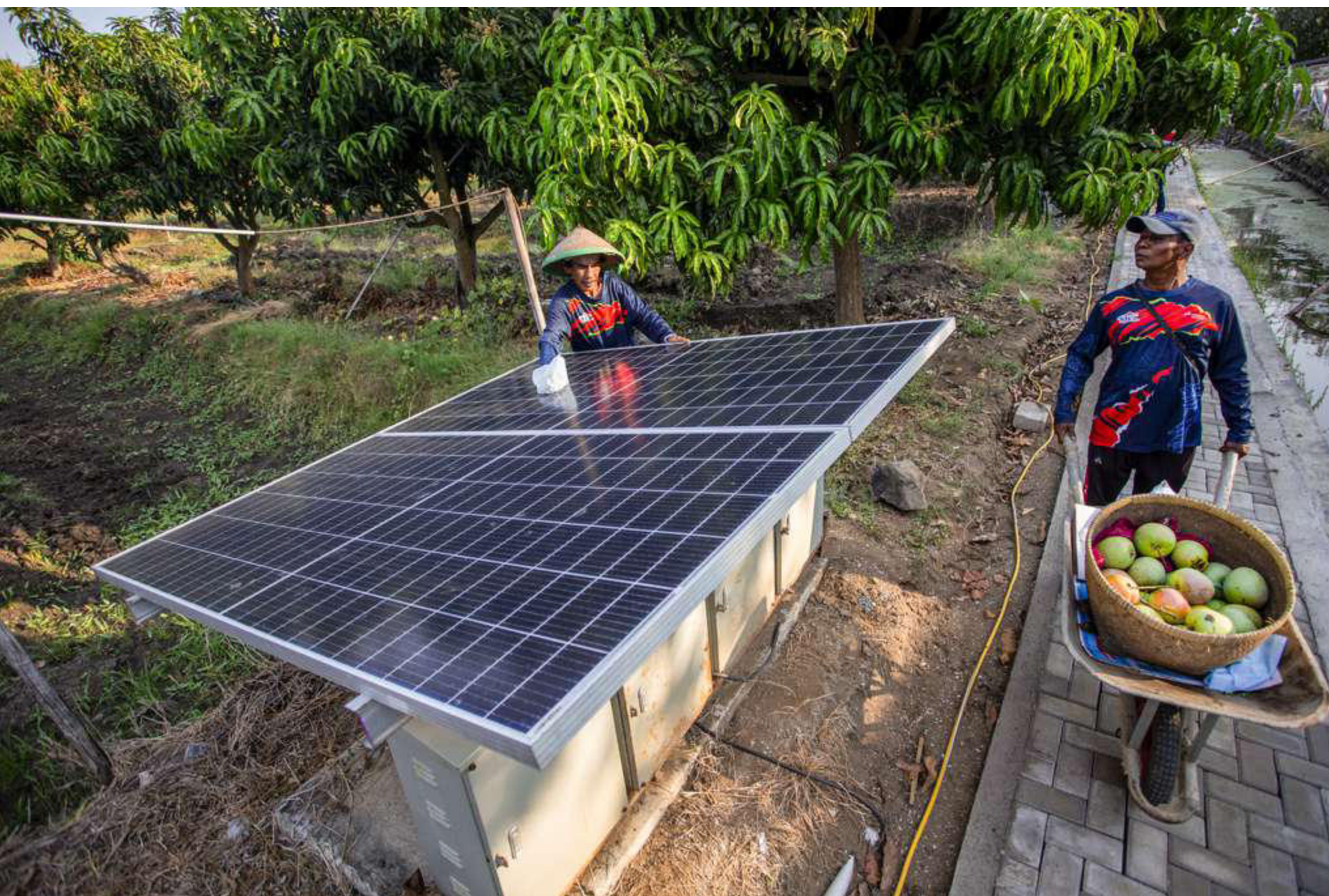
< Pembangkit Listrik Tenaga Hybrid (PLTH) di Dusun Bondan, Desa Ujung Alang, Kampung Laut, Cilacap, Jawa Tengah, Senin (24/10/2022). PLTH yang menggabungkan panel surya dan kincir angin berkapasitas 16.200 Watt Peak (WP) ini dibangun oleh Kilang Cilacap untuk membantu kehidupan warga Dusun Bondan yang sudah 20 tahun tidak mendapat aliran listrik karena kondisi wilayah yang terpencil.
